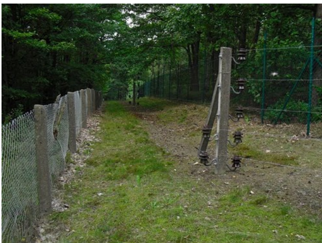
10 kV stängslet runt anläggningen
